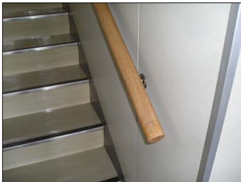
手すりに点字表記がない
